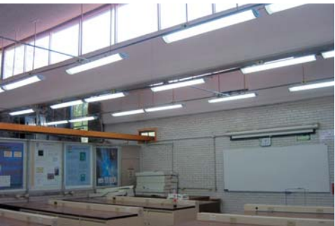
Laborraum mit neuer Beleuchtungsanlage mit Tageslichtregelung
